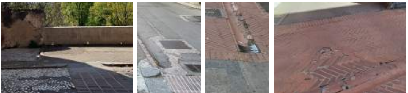
Dettagli: stato conservativo di via Garibaldi (cotto e pietra)
